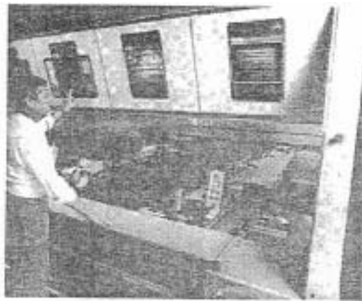
<그림 1> Control Panel(Monforts)사
